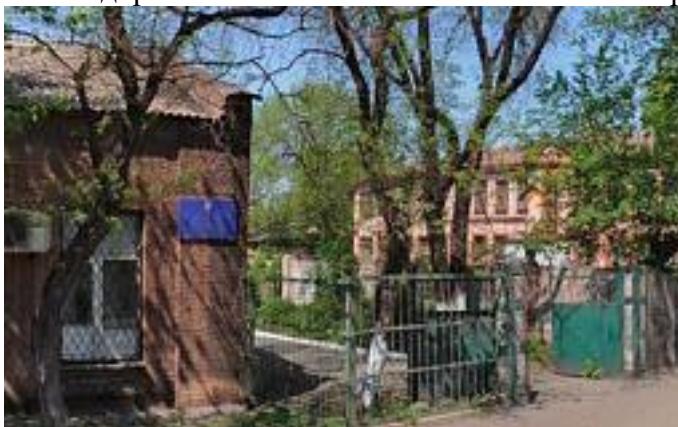
Рис. 36. Зовнішній вигляд фасаду будівлі Кальміуського УПЗСН, що підтверджує неможливість пересуватися там людям на візку
